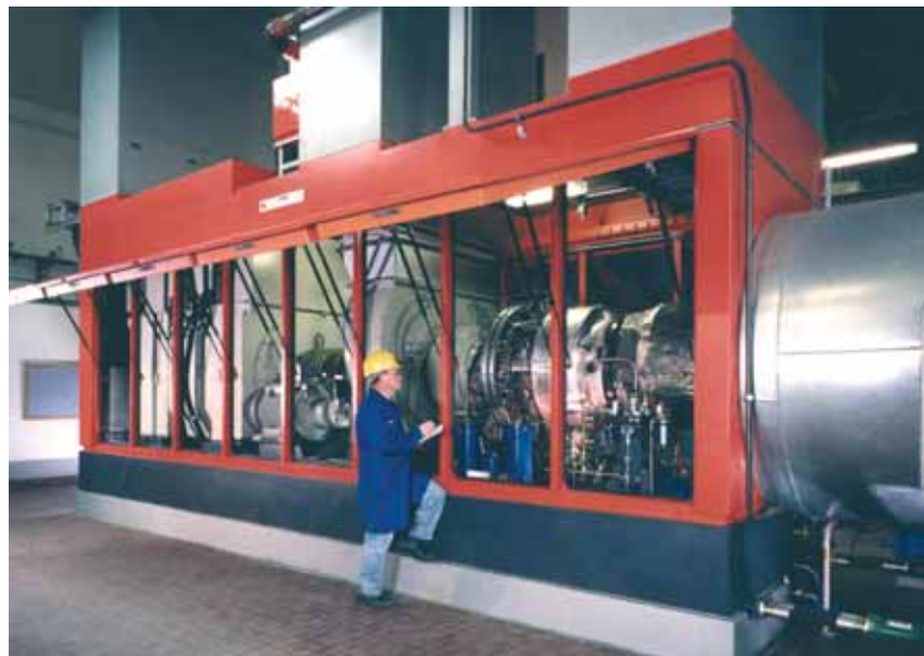
Рис. 2. Газотурбинная установка Solar C50 электрической мощностью 4,6 МВт и тепловой 11,05 МВт, общий КПД равен 80%
